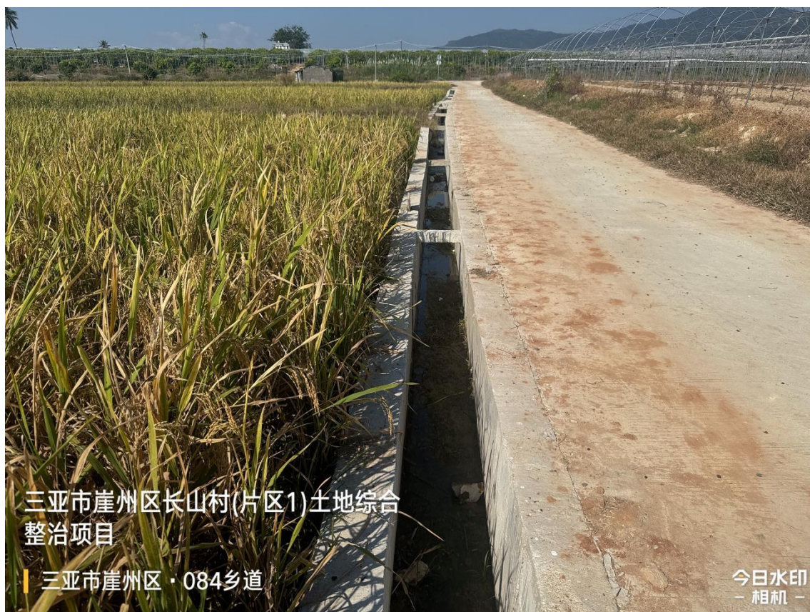
图 3-3-11 排水沟实地照片
