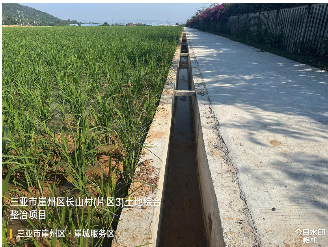
图 3-13 排水沟实地照片
